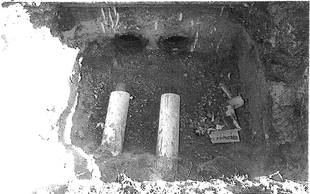
Kivágott fűtésvezeték aknán kívüli szakasz
